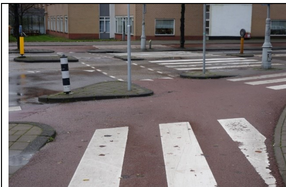
Eiland in rijloper niet goed zichtbaar Zeeburgerdijk - Van Lohuizenstraat
